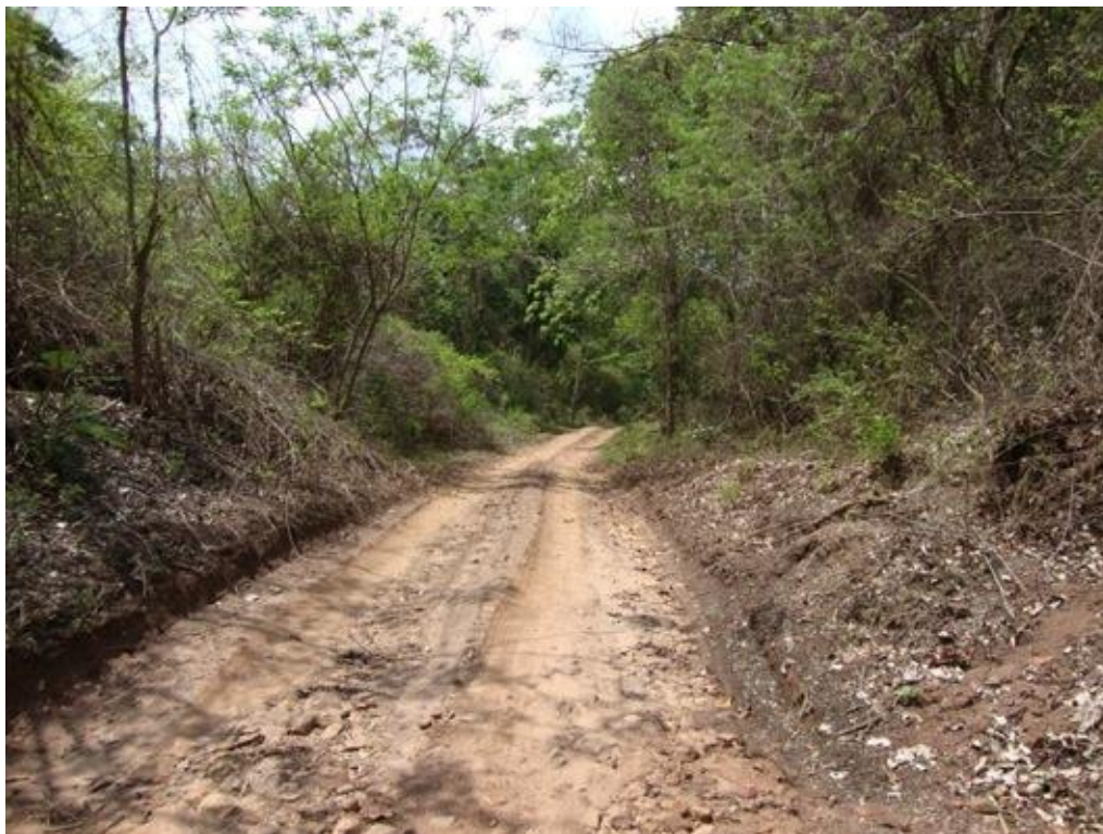
Foto 2. Estrada Rural que corta o Córrego Trinchete sem dispositivos para controle das águas pluviais.
