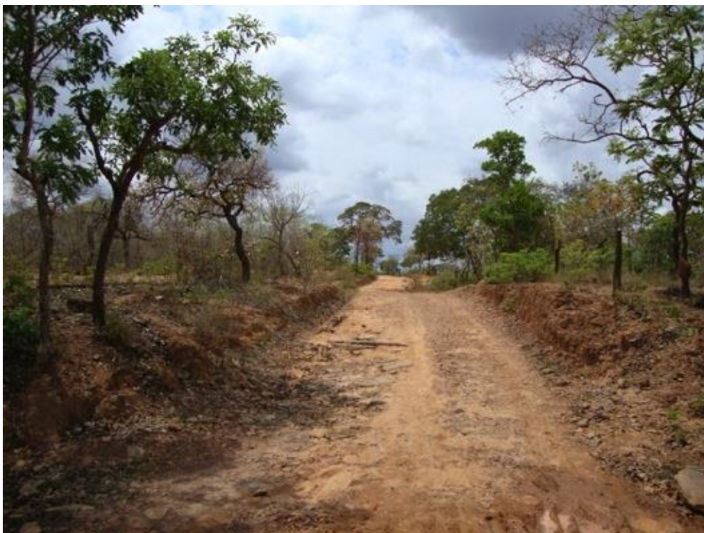
Foto 3. Novamente a estrada que corta o Córrego Trinchete, com processo erosivo instalado e sem dispositivos de controle das águas pluviais.
