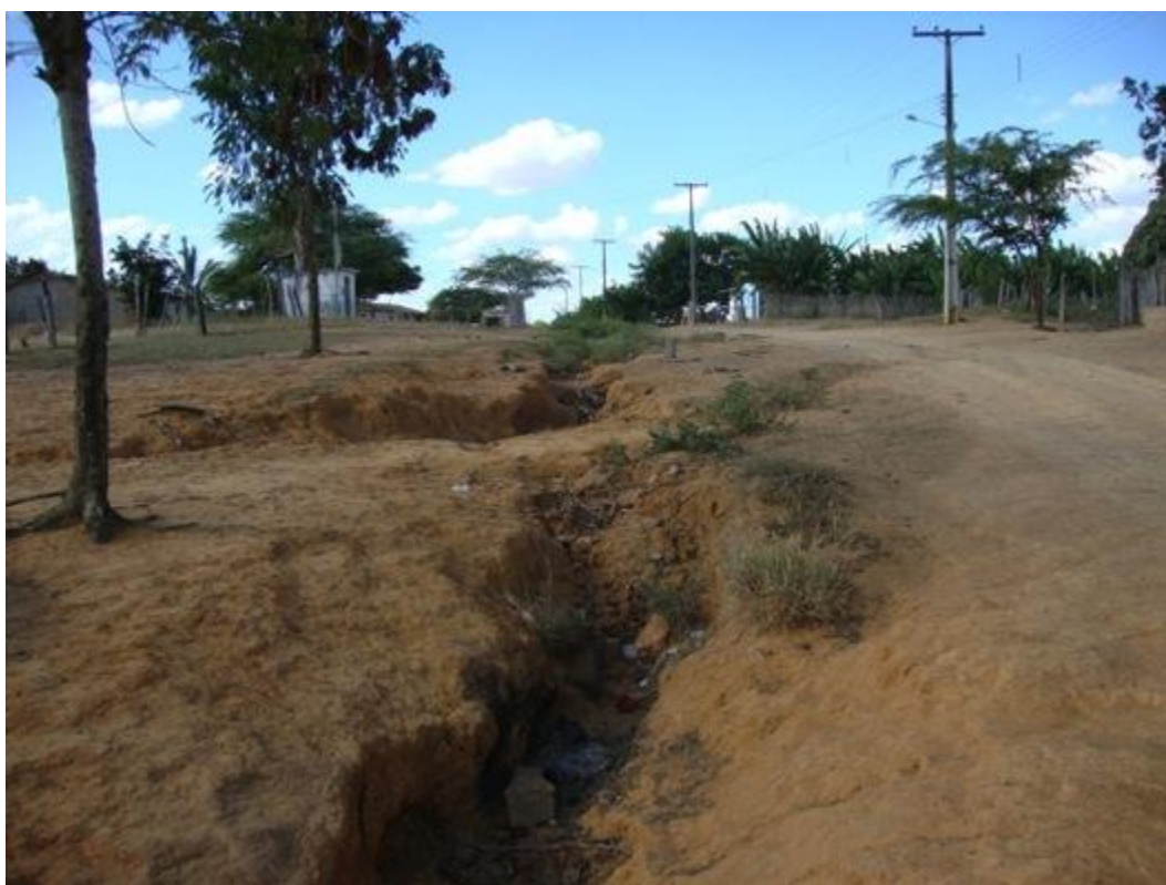
Foto 7: Erosão causada pela falta de medidas de conservação da estrada em comunidade na margem direita do rio Salitre conhecida como Volta Grande.
