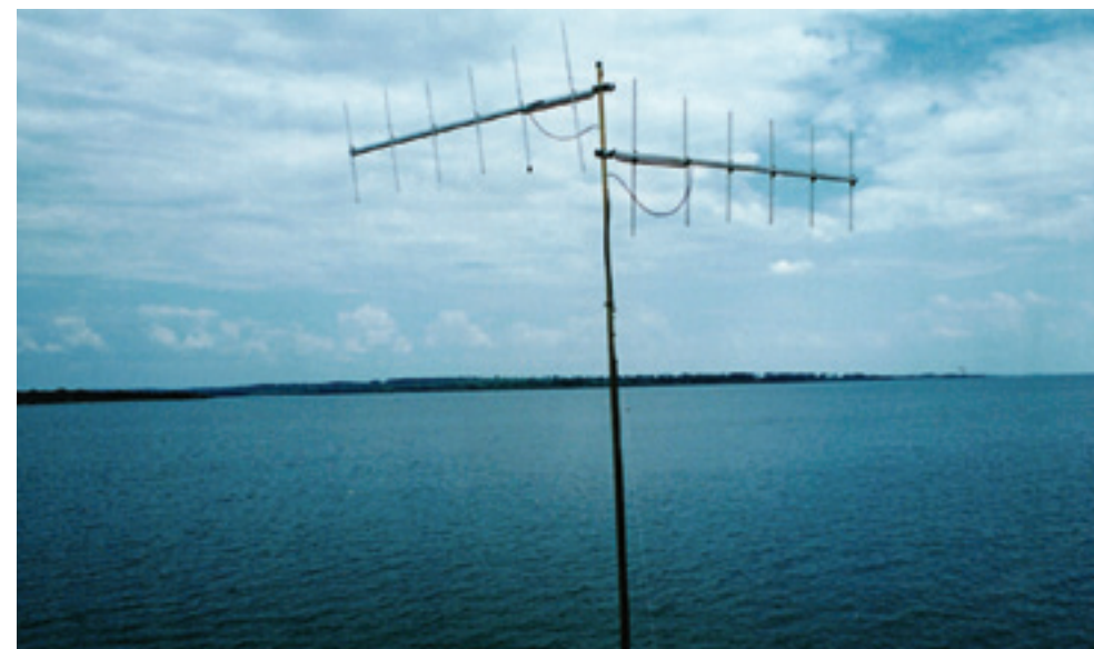
FIGURA 3 – Estação automática de rastreamento com antenas Yagi de 6 elementos instalada na UHE Volta Grande. Foto: Luiz Gustavo M. Silva.
