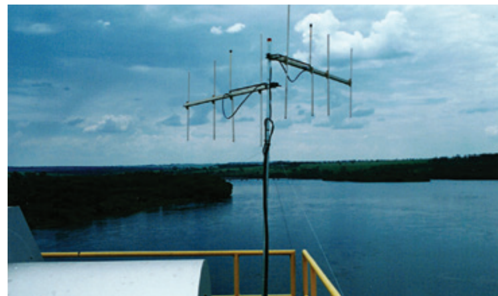
FIGURA 4 – Estação automática de rastreamento com antenas Yagi de 4 elementos instalada na UHE Jaguará. Foto: Luiz Gustavo M. Silva.
