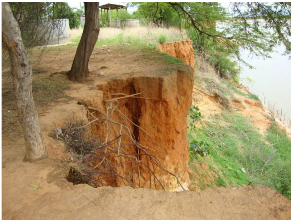
Figura 9 - Processos erosivos nas margens mostrando raízes expostas.
