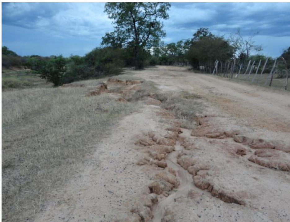
Fotografia 4 – Trecho de estrada próximo a BA-349 com desenvolvimento de processos erosivos.
