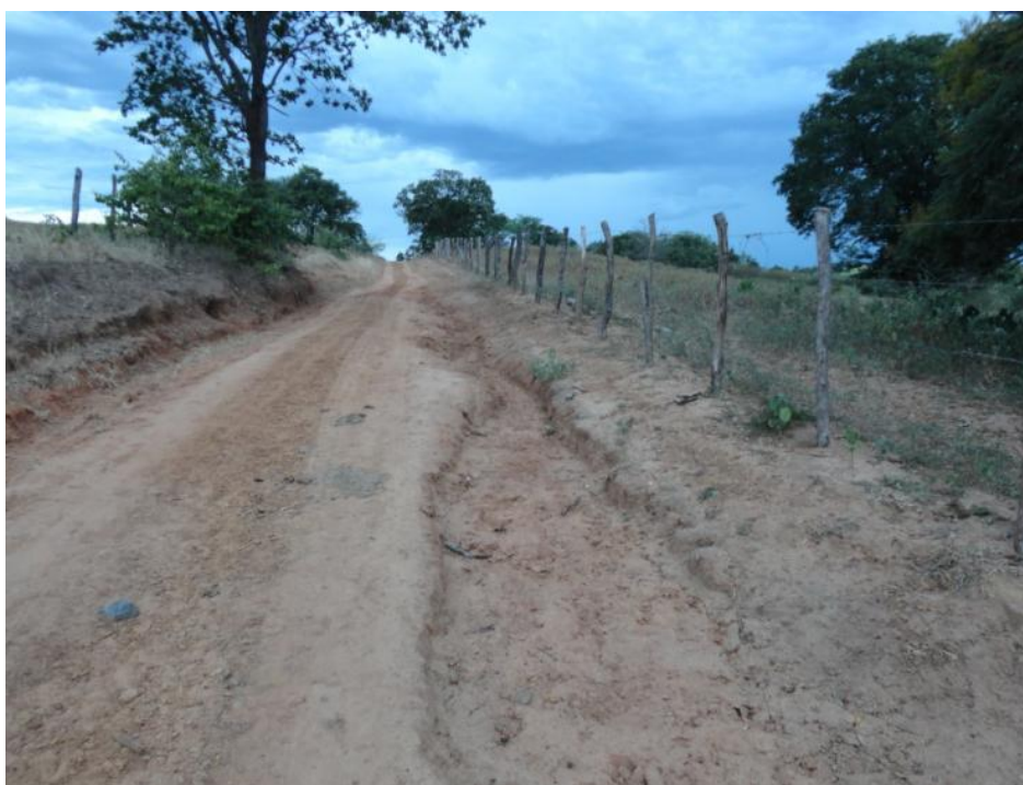
Fotografia 5 – Trecho de estrada com desenvolvimento de processos erosivos.
