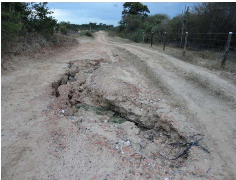
Fotografia 7 – Trecho com processo erosivo localizado
