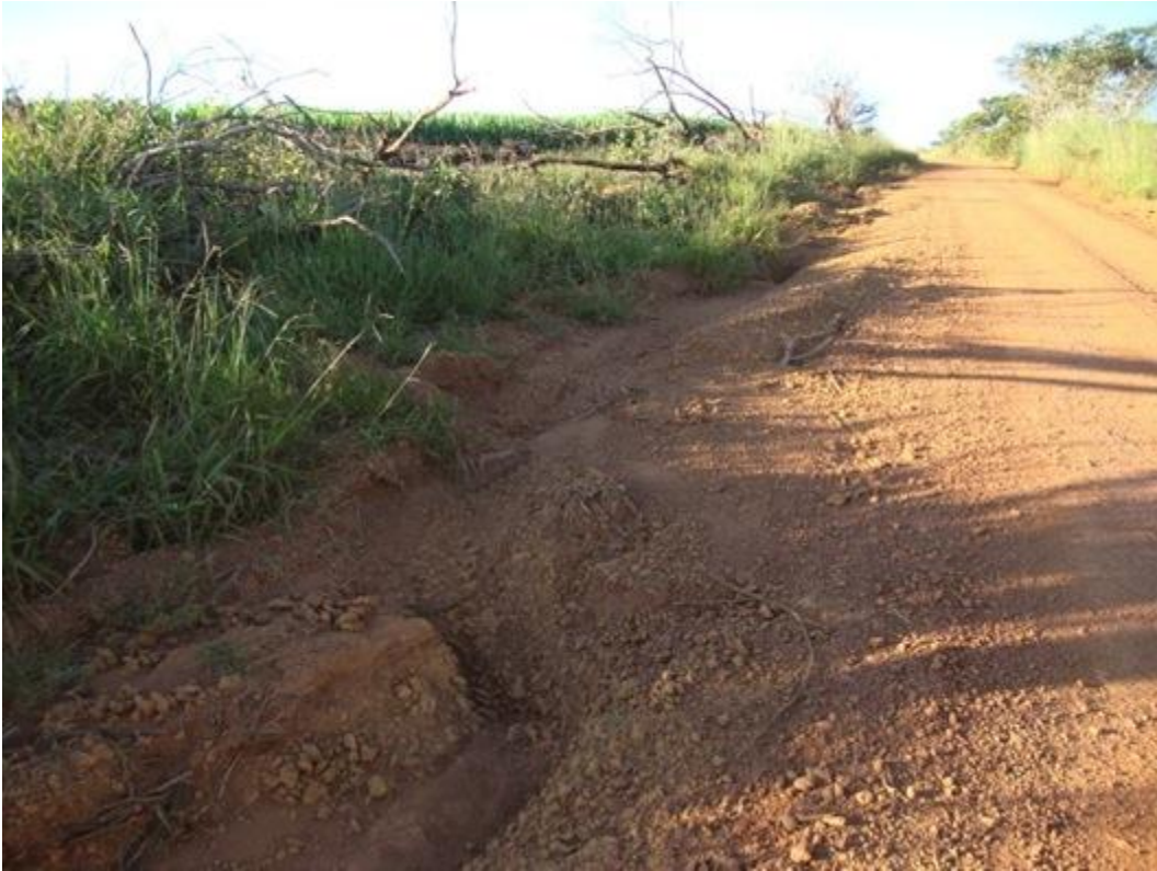
Figura 4: Processo erosivo instalado ao lado de estrada sem medidas de controle de águas pluviais.
