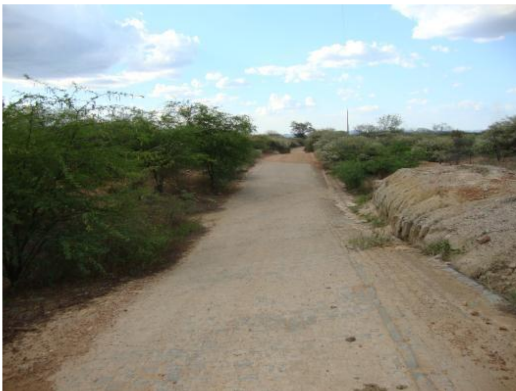
Figura 24 - Exemplo de passagem molhada de pedra no córrego Onça, Afogados da Ingazeira/PE.
