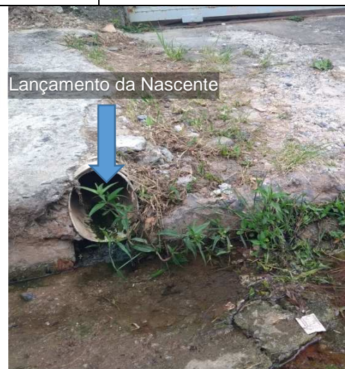
Ponto de lançamento da nascente drenada.
