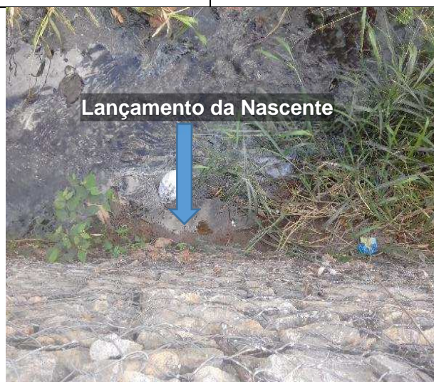
Vista superior da exfiltração no canal de drenagem
