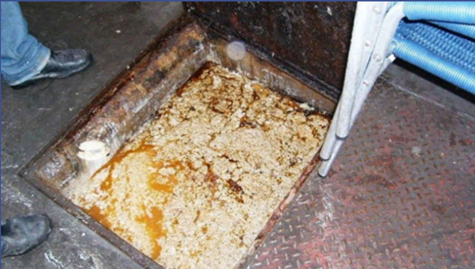
Foto 8.1 – Caixa de gordura necessitando de limpeza (Fonte: https://www.limpafossa.com.br/limpeza-de-caixa-de-gordura-em-condominio-periodicidade/ - Acesso 11/01/2022)
