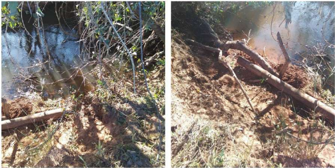
Figura 5.305 – Processos erosivos da Propriedade 55
