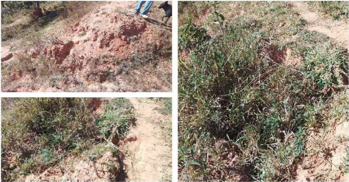
Figura 5.138 – Processos erosivos da Propriedade 22
