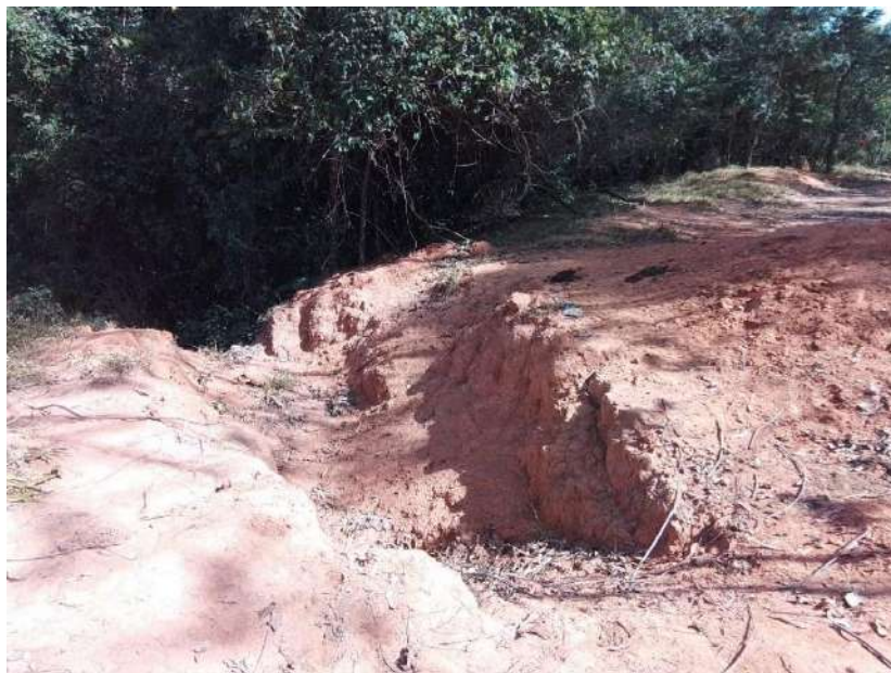
Figura 5.390 – Processo erosivo da Propriedade 75
