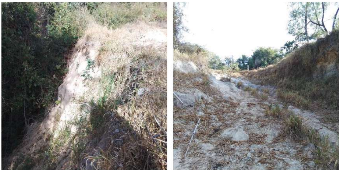
Figura 5.404 – Processos erosivos da Propriedade 78
