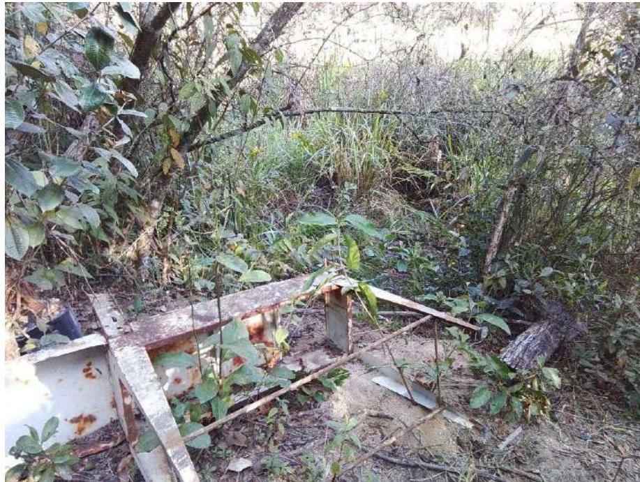
Figura 5.53 – Área da nascente desprotegida da Propriedade 8
