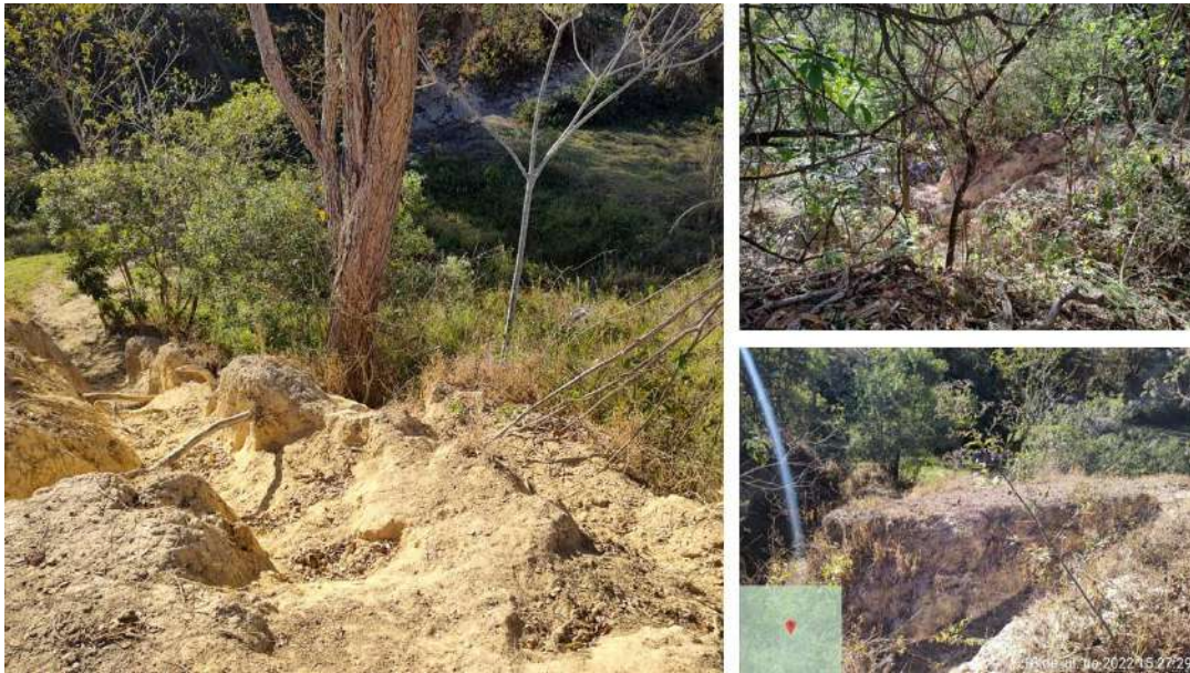
Figura 5.281 – Processos erosivos da Propriedade 49
