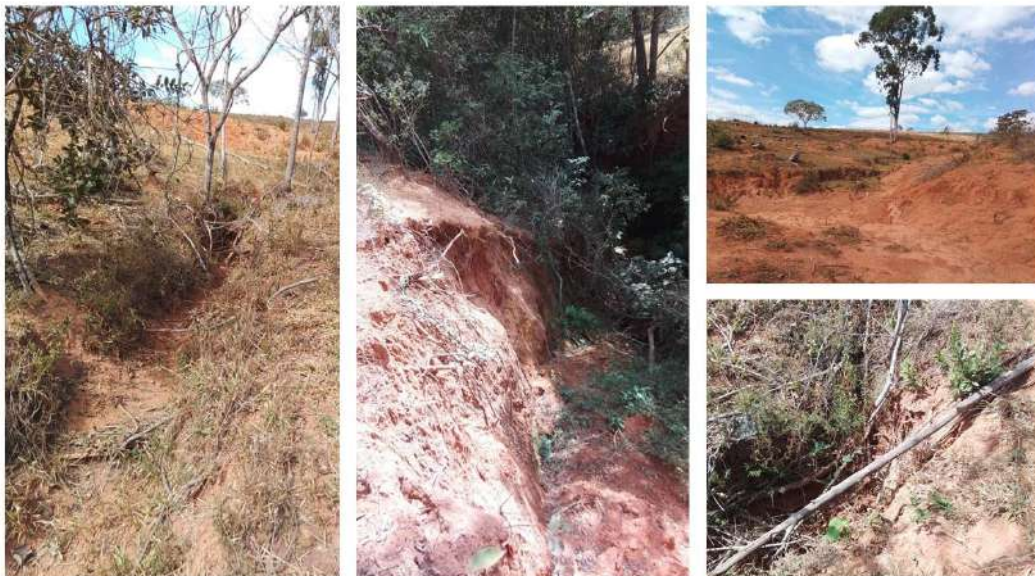
Figura 5.317 – Processos erosivos da Propriedade 57
