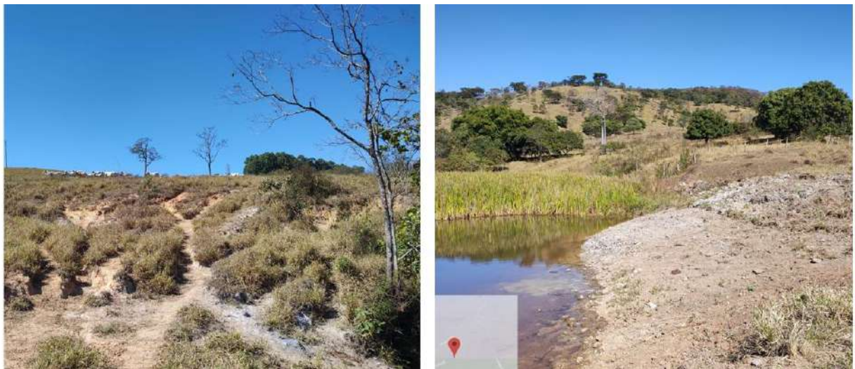
Figura 5.157 – Processos erosivos da Propriedade 25
