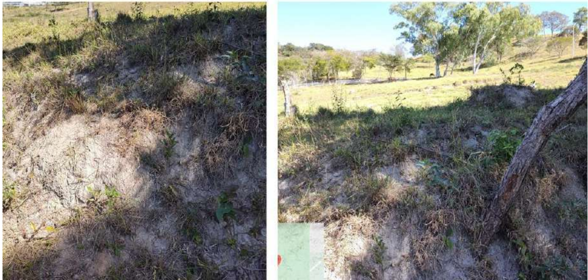
Figura 5.170 – Processos erosivos da Propriedade 27
