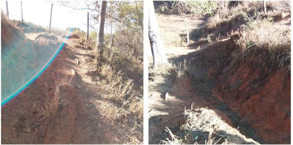
Figura 5.123 – Processos erosivos da Propriedade 20
