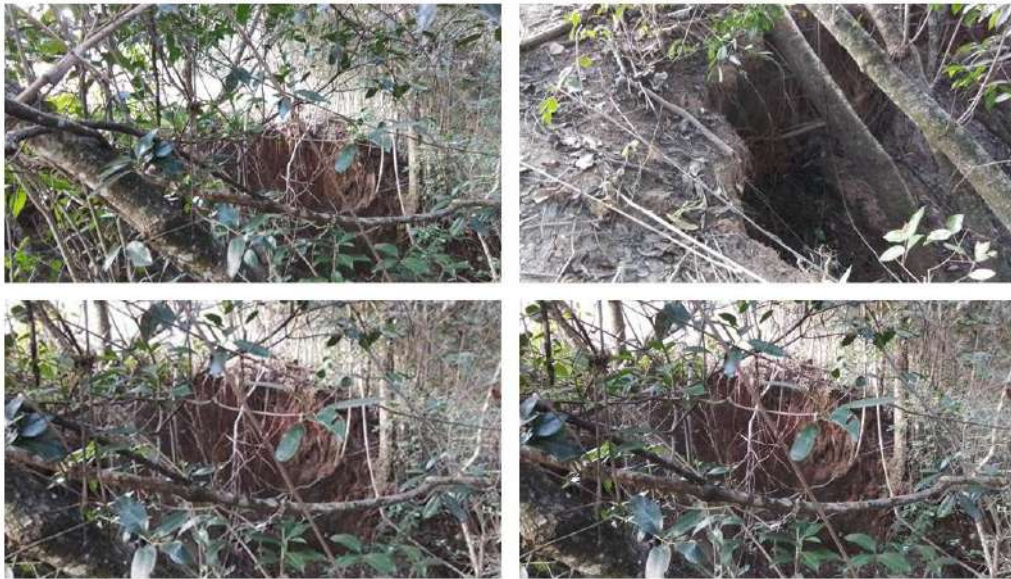
Figura 5.43 – Processos erosivos da Propriedade 5
