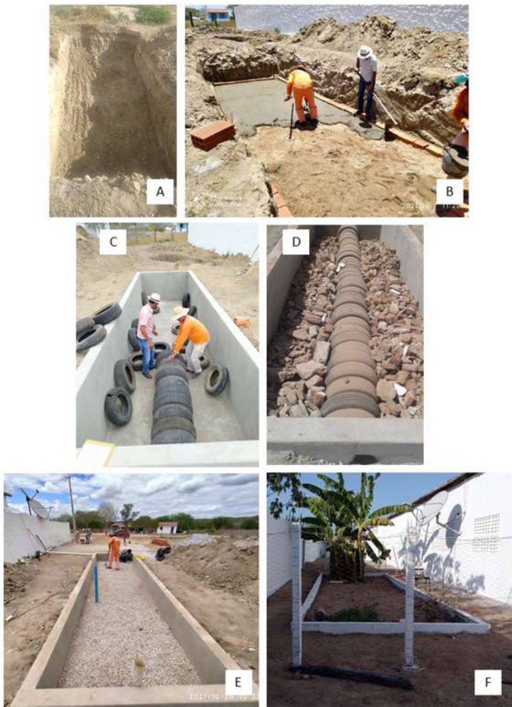
Figura 7 - Etapas construtivas das fossas agroecológicas: (A) Vala aberta; (B) Impermeabilização; (C) Pneus; (D) Camada de entulho; (E) Camada de brita; (F) Fossa agroecológica finalizada
