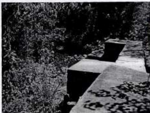
Figura 19 - Detalhe do barramento ruído.
