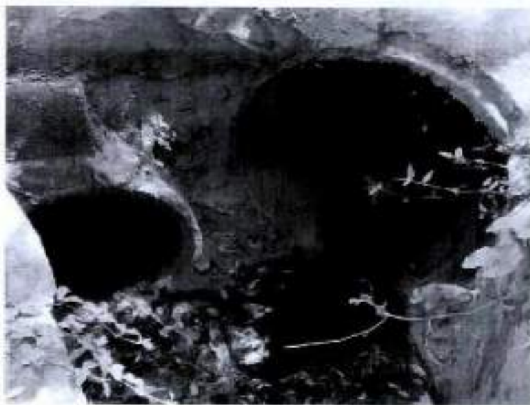
Figura 58 - Lançamento de esgoto no riacho.
