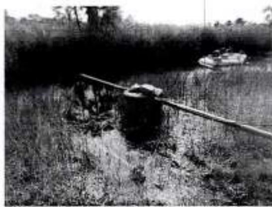
Figura 44: Detalhe das duas captações de água, a primeira feita pela Prefeitura de Catolândia e a segunda mais no meio do rio da Embasa.
