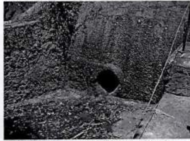
Figura 27 - Descarga de fundo inutilizada.
