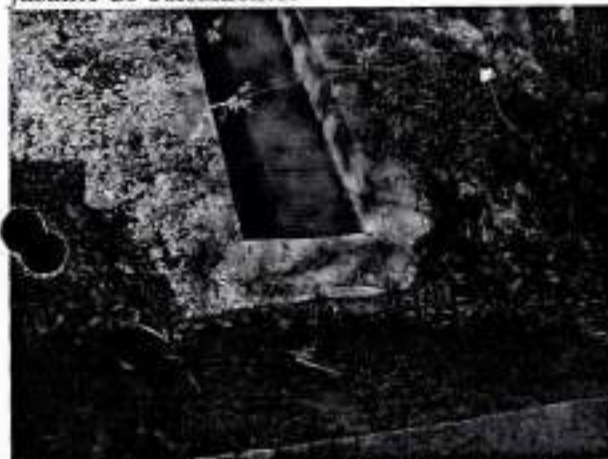
Figura 33 - Canal de derivação de água do Ribeirão Boa Sorte.
