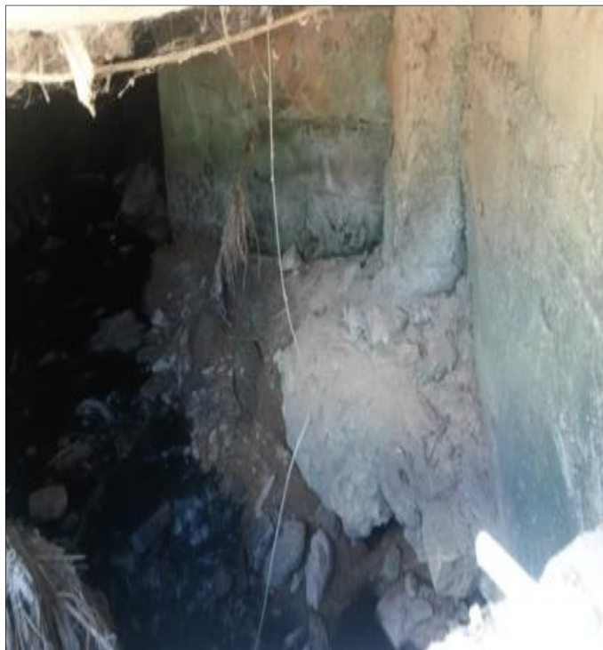
Figura 42: Galeria de drenagem pluvial com esgoto na rua Joaquim Pinto Lara Fonte: PRO BRAS, 2017
