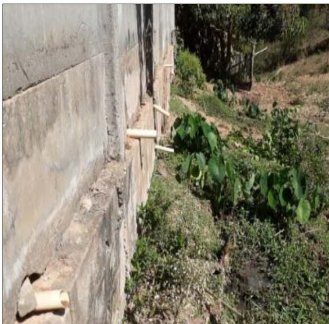
Figura 39: Lançamento de esgoto a céu aberto – bairro Fonte das Pedras Fonte: PRO BRAS, 2017
