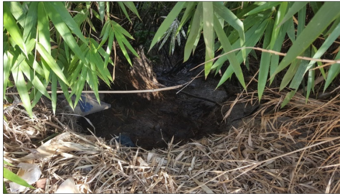
Figura 45: Lançamento de esgoto na rua Armando de Moraes Fonte: PRO BRAS, 2017
