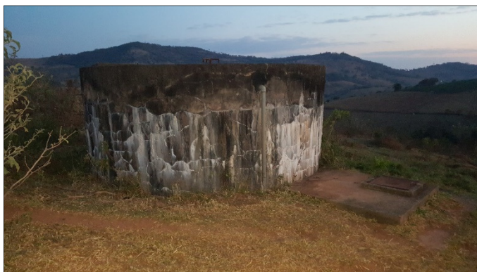
Figura 33: Reservatório de água - comunidade Morro Verde Fonte: PRO BRAS, 2017
