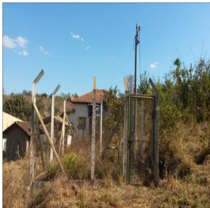
Figura 23: Captação subterrânea – comunidade Cachoeirinha
