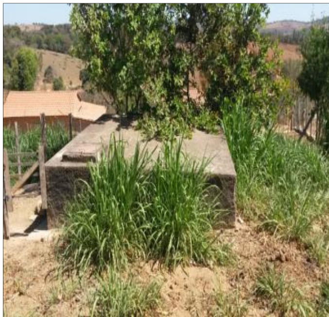
Figura 37: Reservatório de água - comunidade Tatu Fonte: PRO BRAS, 2017
