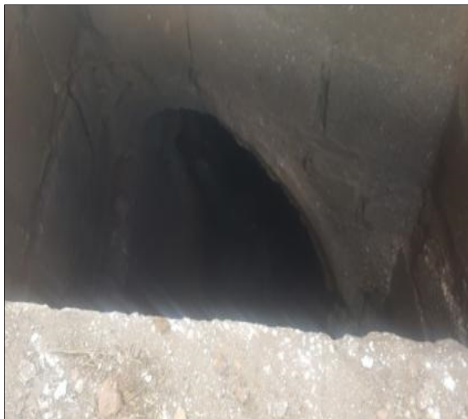
Figura 92: Estrutura da rede de drenagem pluvial - rua Joaquim Pinto Lara
