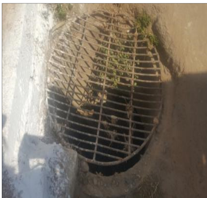
Figura 93: Estrutura da rede de drenagem pluvial - rua Joaquim Pinto Lara
