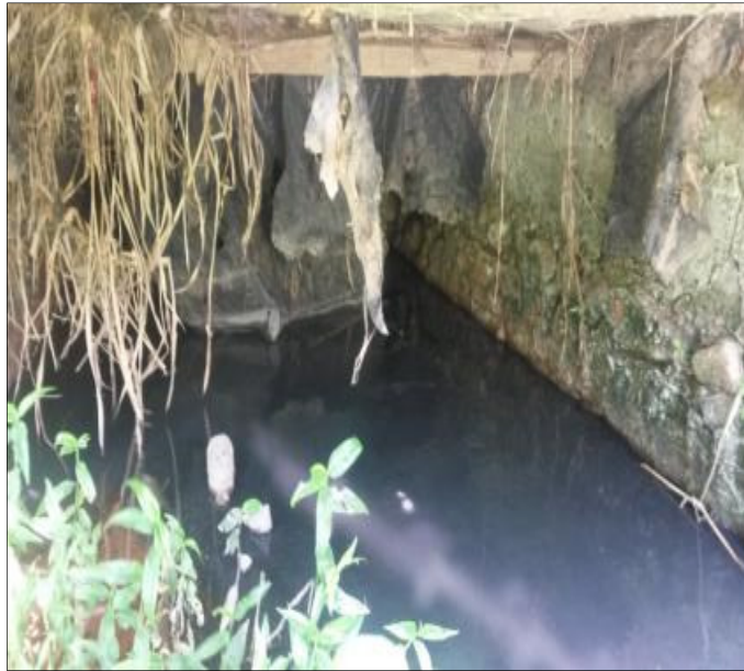
Figura 43: Galeria de drenagem pluvial com esgoto na rua Joaquim Pinto Lara Fonte: PRO BRAS, 2017
