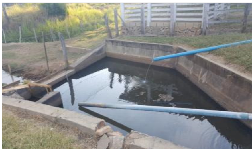
Figura 16: Captação na comunidade Laje – Foto 2
