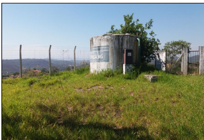
Figura 29: Reservatório II para atender o bairro Inácia de Carvalho Fonte: PRO BRAS, 2017
