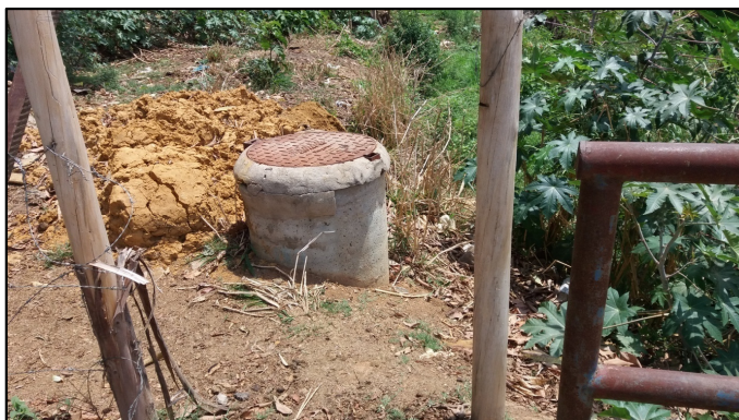
Figura 32: Poços de visitas
