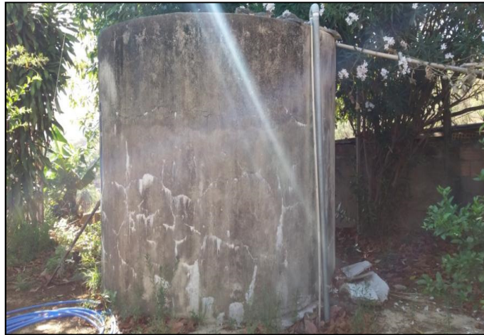
Figura 26: Reservatório para atender o bairro Maravilhas Fonte: PRO BRAS, 2017
