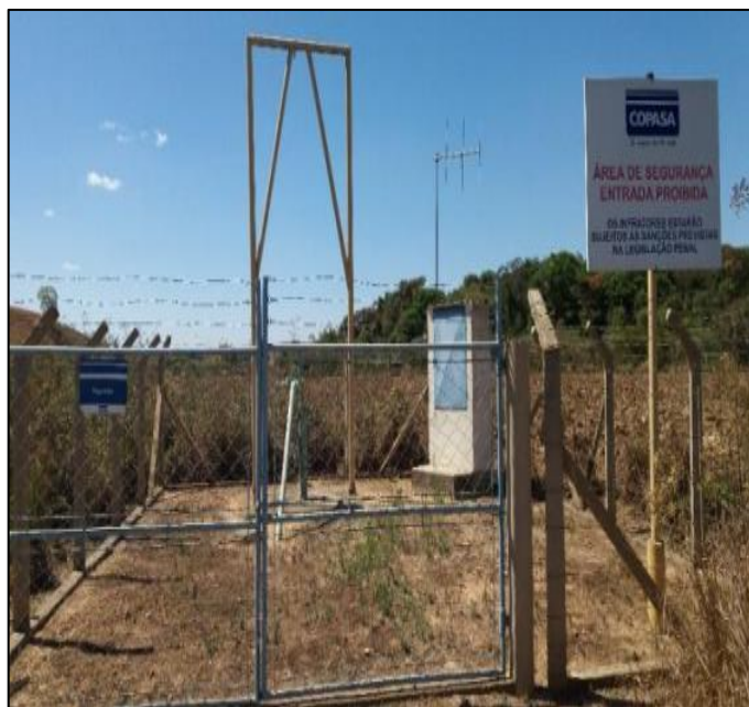
Figura 13: Poço de captação - água bruta Fonte: PRO BRAS, 2017
