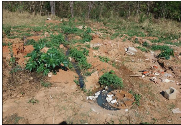
Figura 19: P4 – Conjunto de fossas sem manutenção
