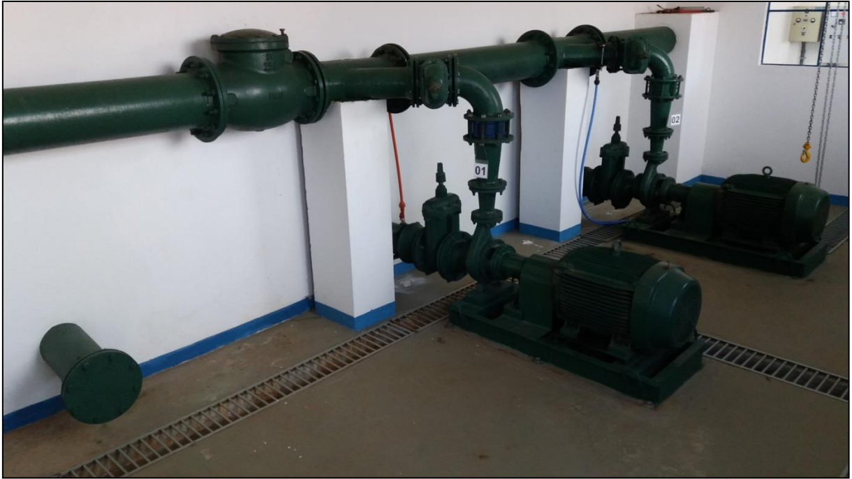
Figura 77: Conjunto moto bomba na ETA
