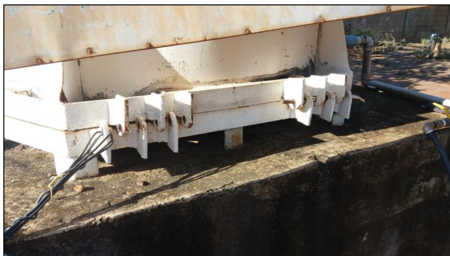
Figura 131: Ausência de parafuso para sustentação do reservatório – Lagoa do Meio
