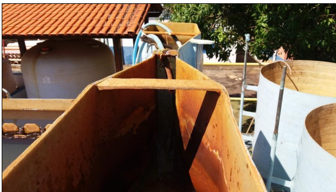
Figura 68: Calha Parshall na ETA
