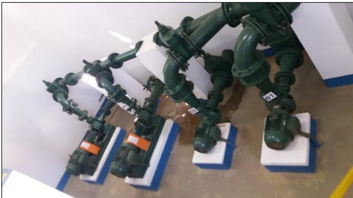
Figura 85: Conjunto moto bomba para atender o reservatório de 254 m 3
