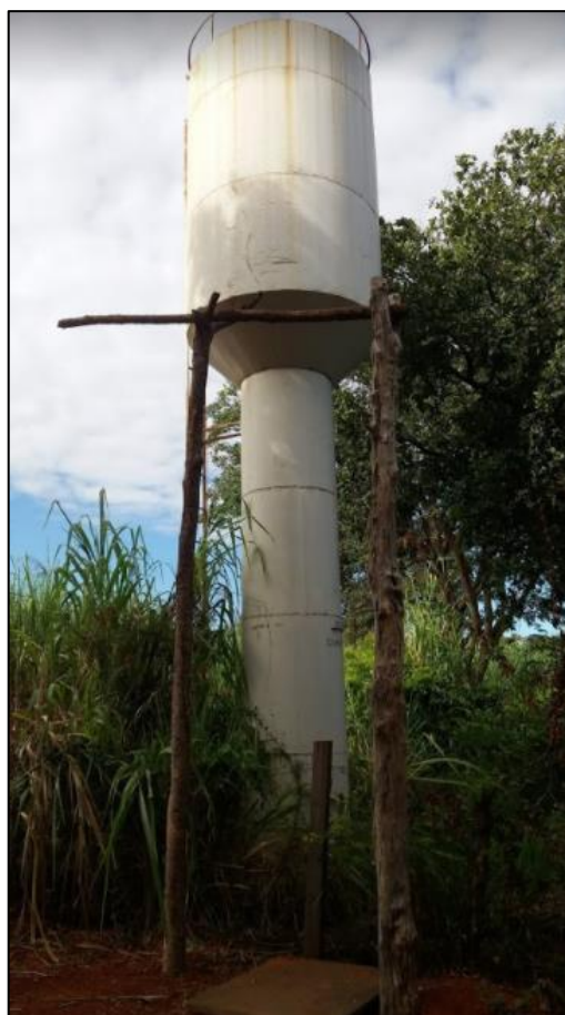
Figura 106: Reservatório – Comunidade Universo
