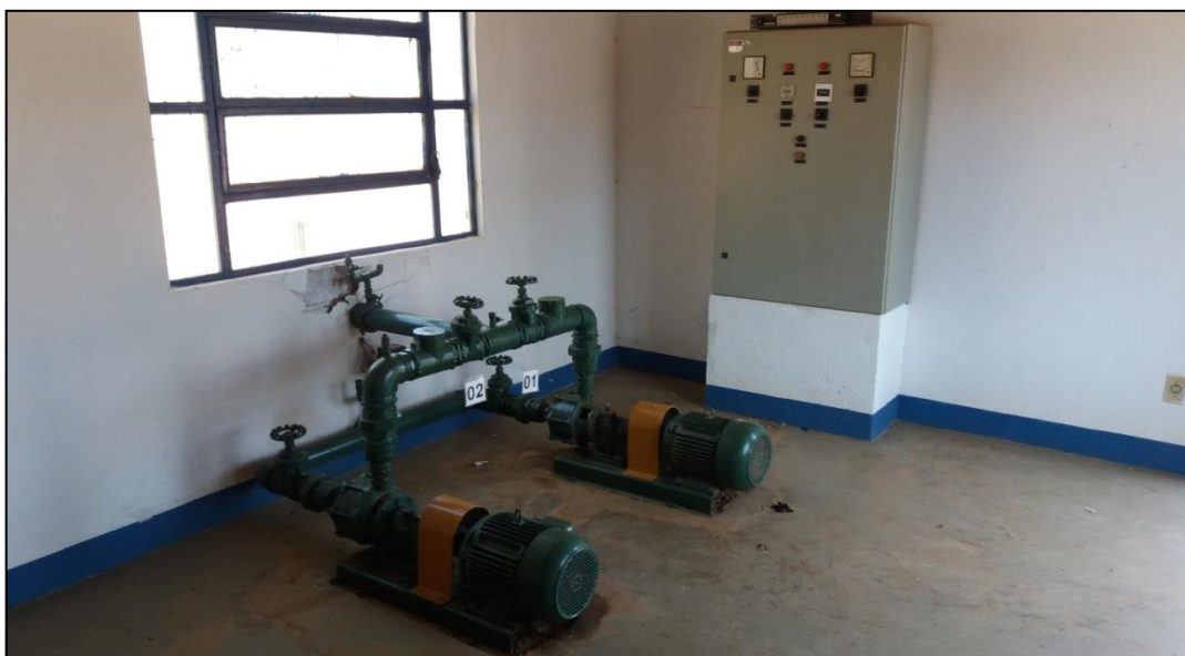
Figura 91: Booster e conjunto moto bomba
