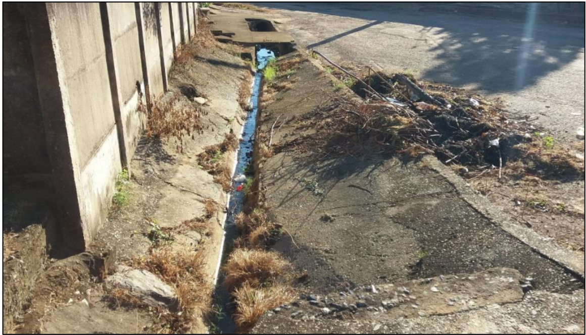
Figura 245: Rua A antes do descarte no córrego Pelame
