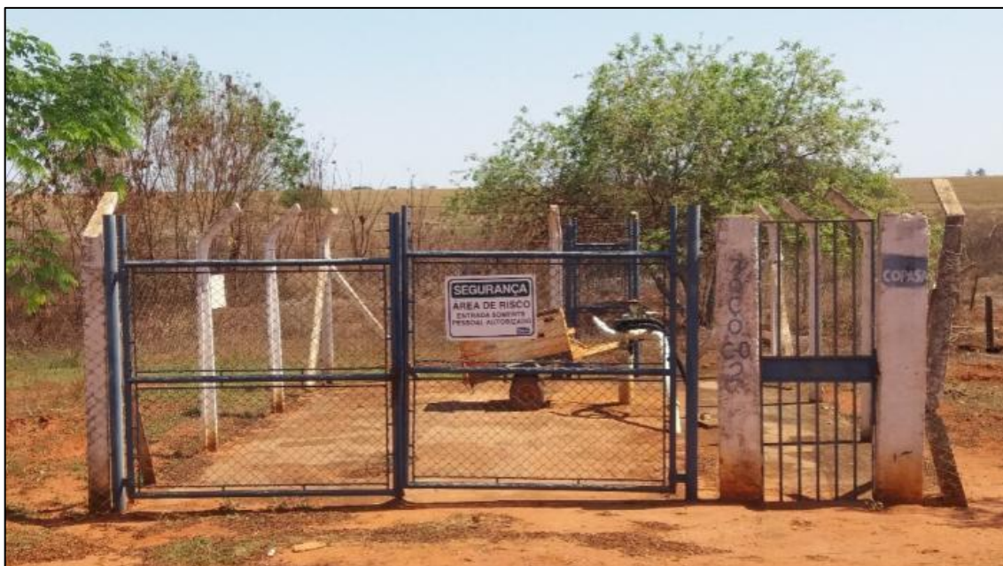
Figura 98: Captação subterrânea – SAA São José do Buriti
