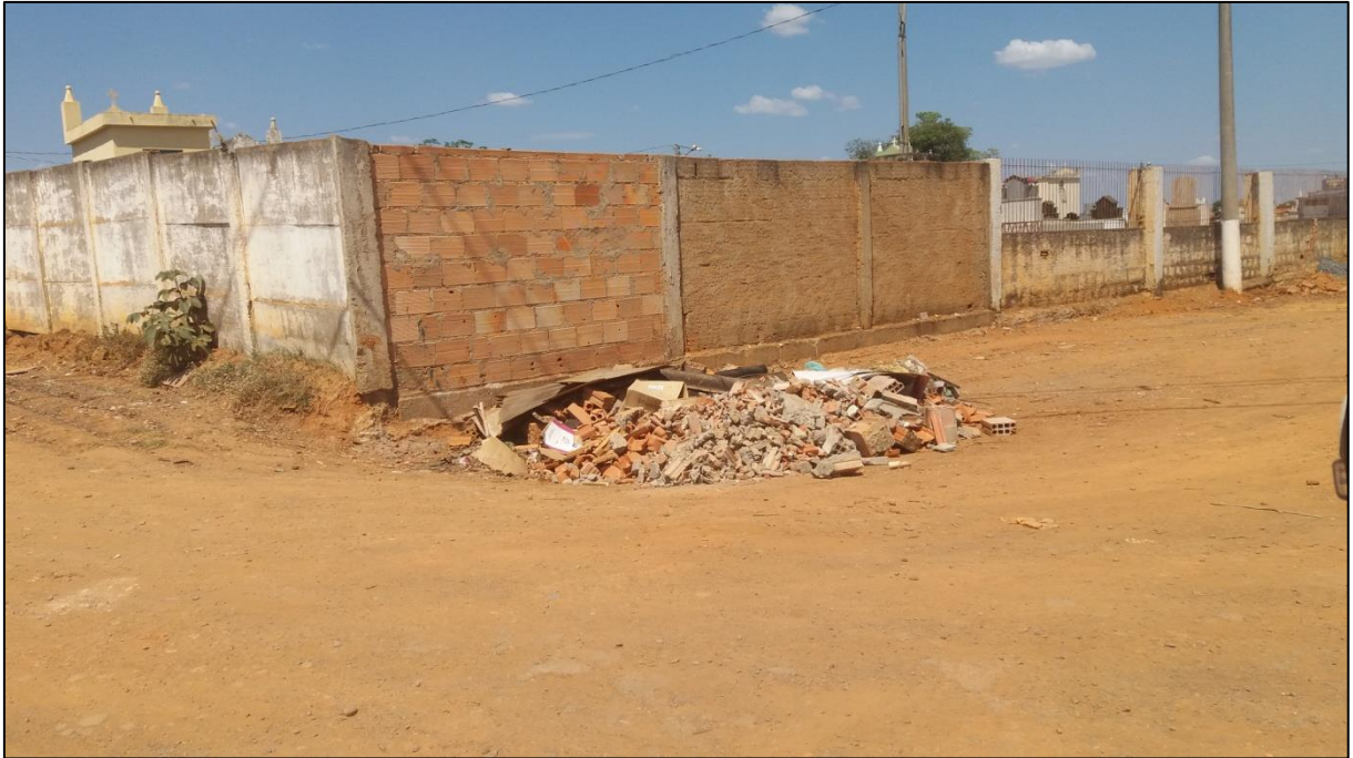
Figura 196: Disposição inadequada de RCC, Avenida Tancredo Neves
