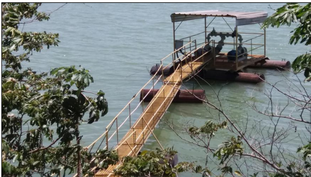
Figura 61: Balsa de captação superficial de água bruta
