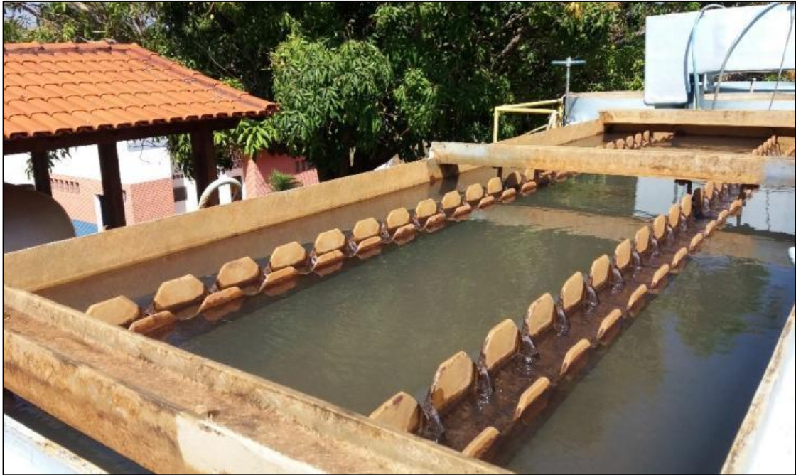
Figura 70: Decantadores na ETA
