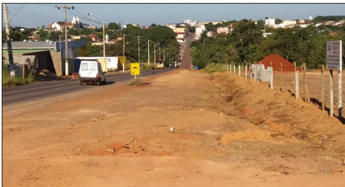
Figura 223: Rodovia Municipal José Mauro Gonçalves sem drenagem
