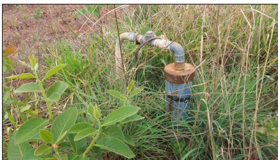
Figura 148: Captação – Várzea Grande
