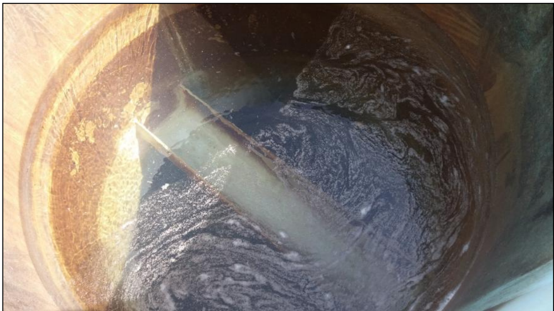
Figura 71: Filtros na ETA
