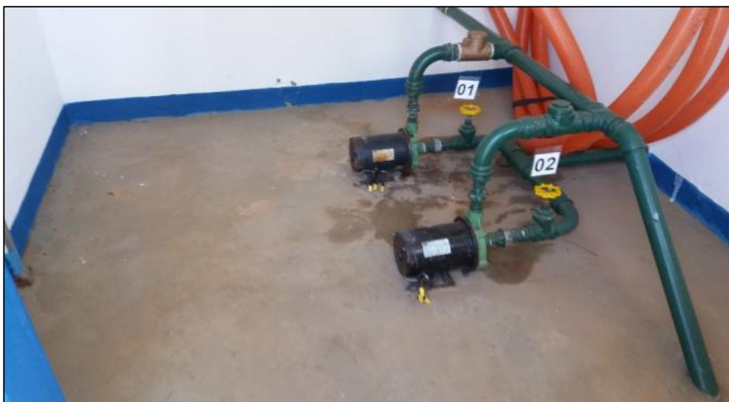
Figura 88: Conjunto de moto bomba do bairro Nossa Senhora de Fátima
