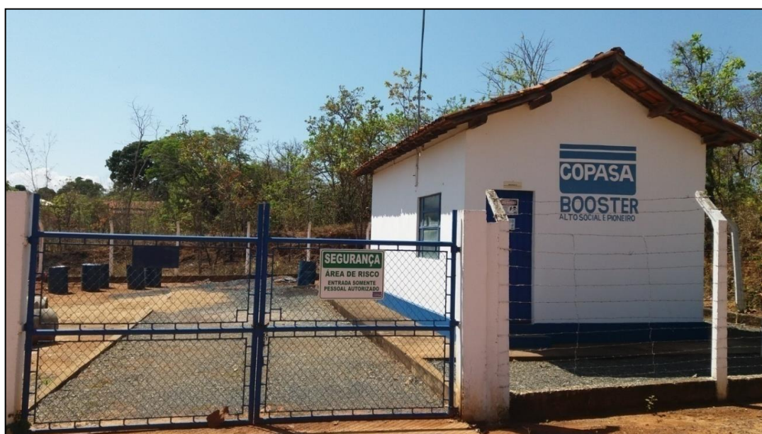
Figura 92: Isolamento do Booster e conjunto moto bomba
