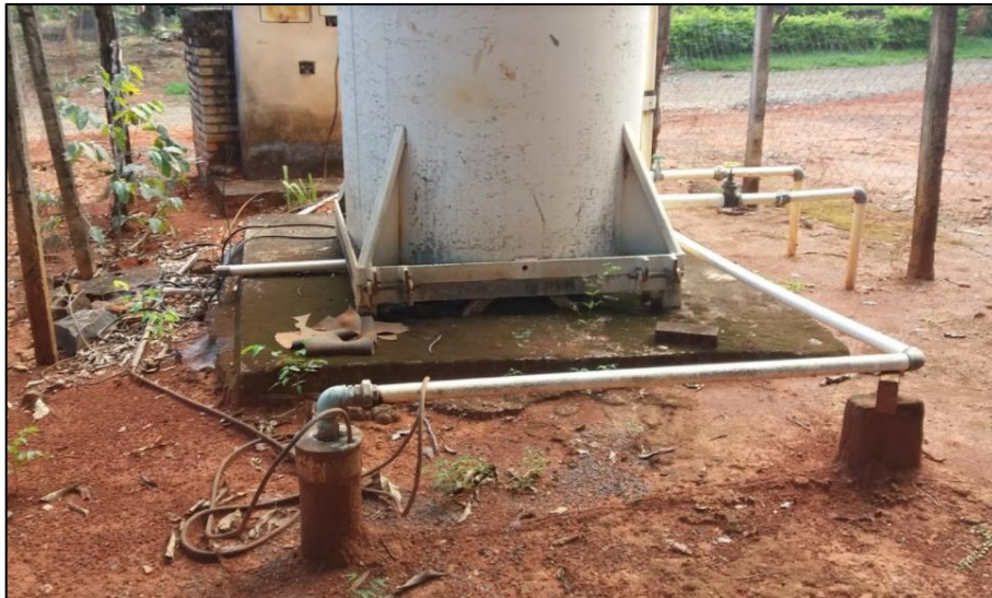
Figura 103: Captação – Estância das Garças
