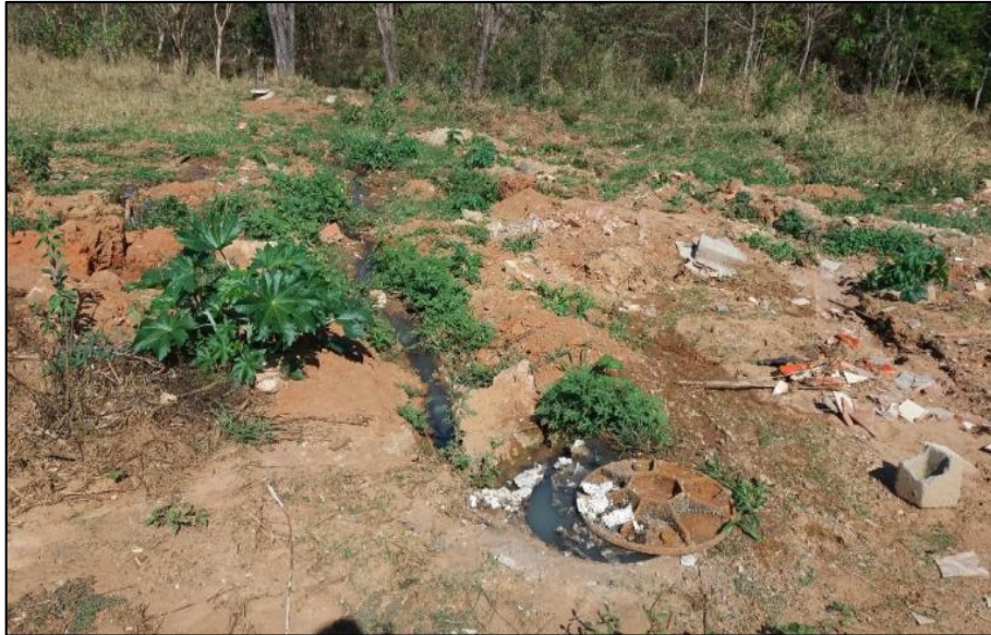
Figura 159: P4 – Conjunto de fossas sem manutenção
