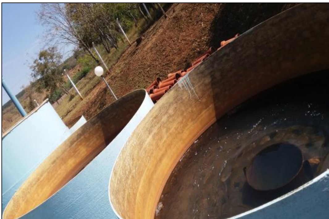
Figura 69: Floculadores na ETA
