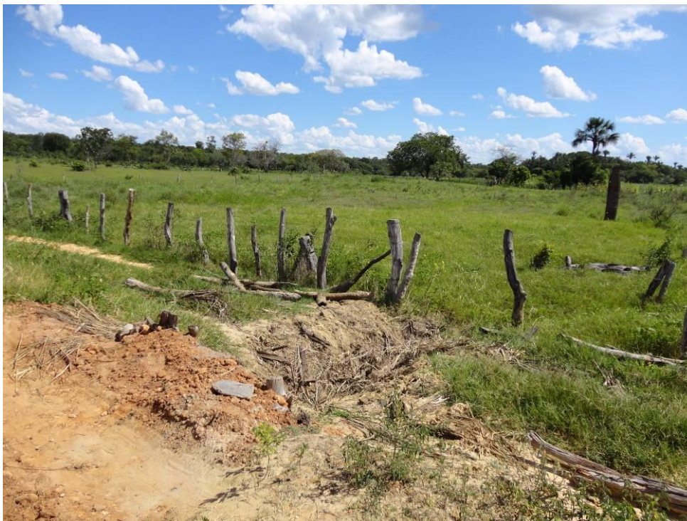
Foto 8 - Passagem da estrada sobre o rio Camaçari, impedindo o fluxo de água e implantação de pastagens nas áreas das veredas a jusante.
