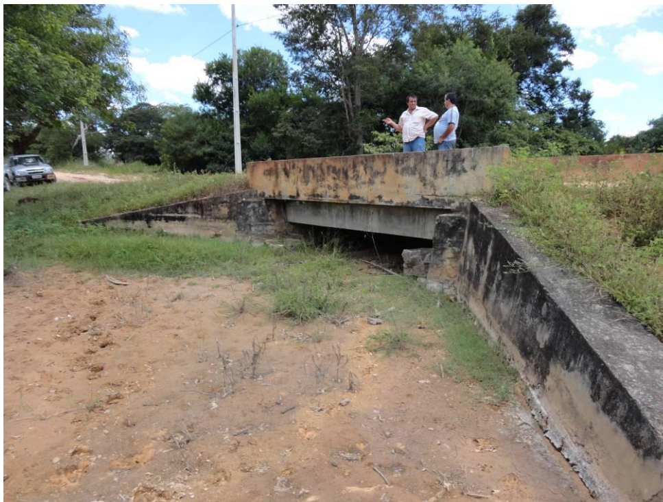
Foto 1 - Ponte sobre o rio Camaçari assoreada pelos sedimentos
