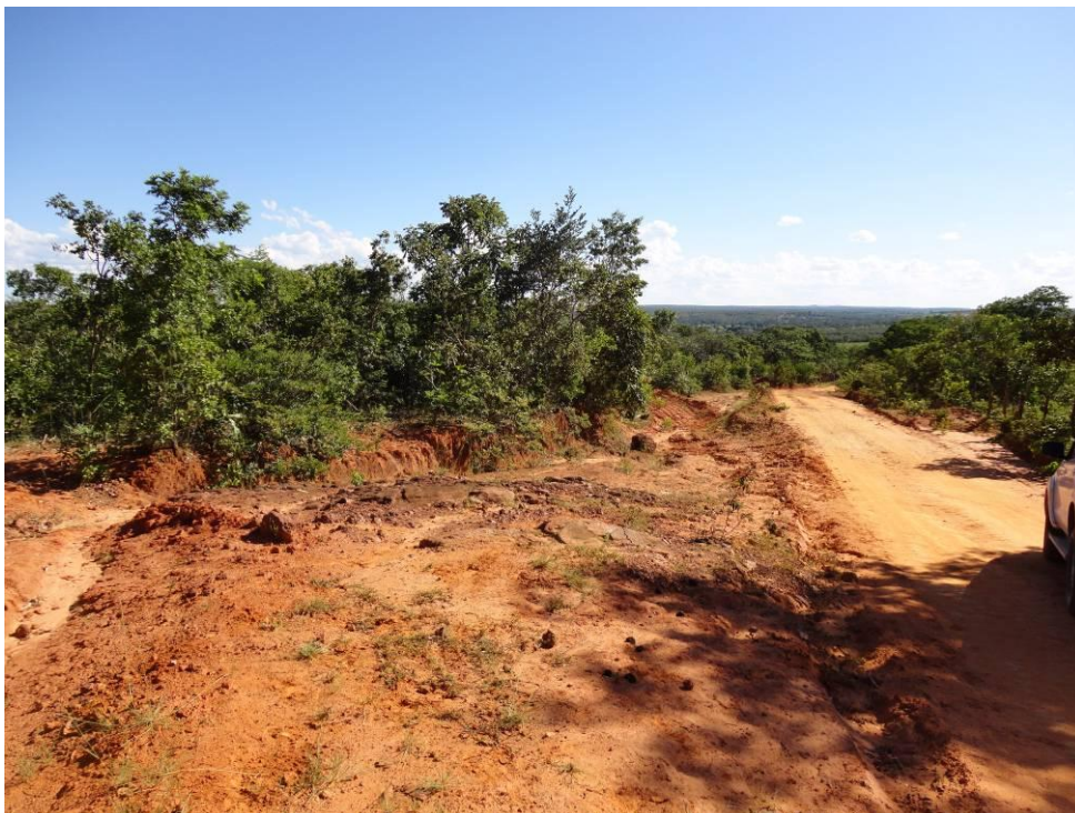
Foto 4 - Estrada apresentando processos erosivos.
