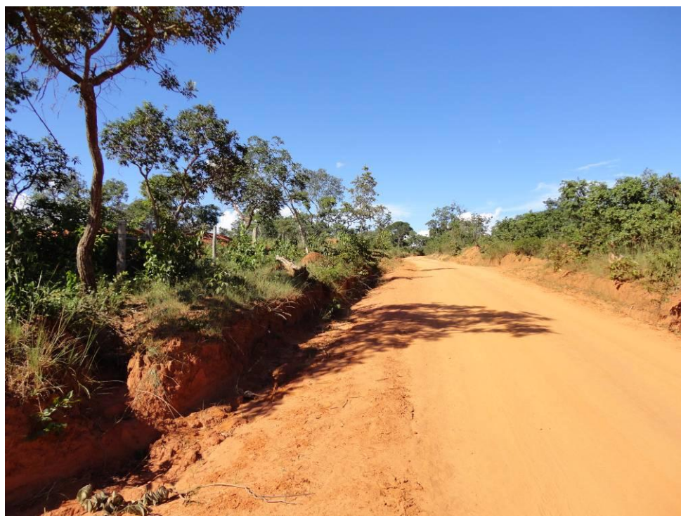
Foto 3- Estrada com processos erosivos nas margens.
