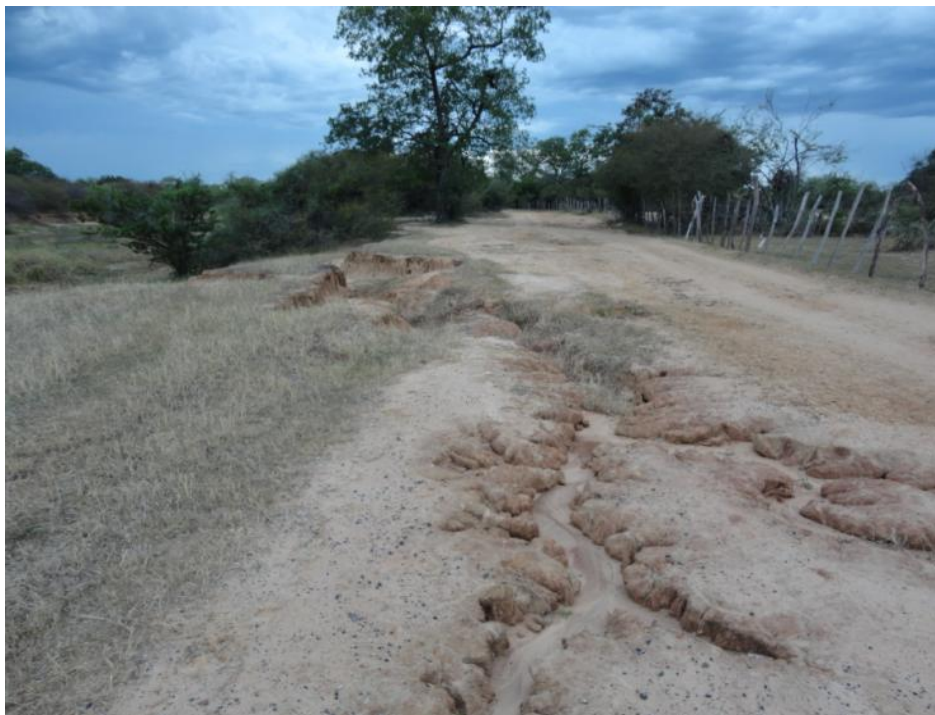
Figura 11 - Trecho de estrada próximo a BA-349 com desenvolvimento de processos erosivos.
