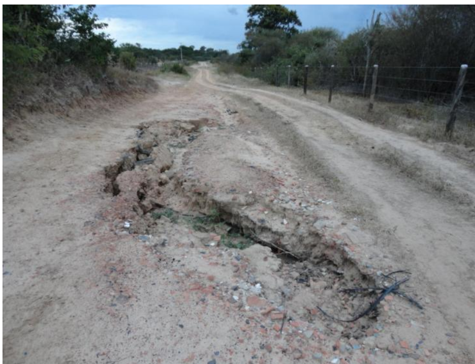
Figura 14 - Trecho com processo erosivo localizado
