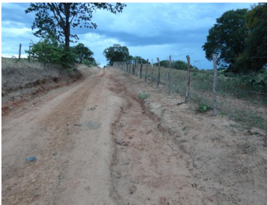
Figura 12 - Trecho de estrada com desenvolvimento de processos erosivos.
