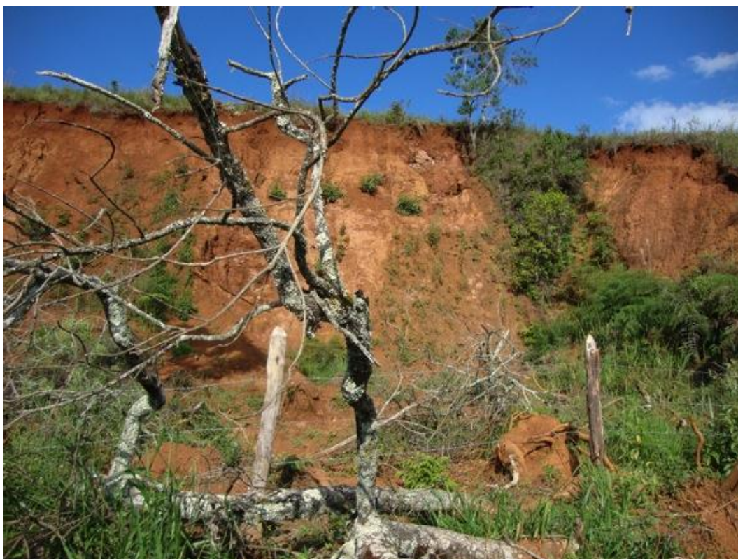
Figura 5: Área de latossolo em corte feito por estrada rural em processo de desbarrancamento, causando inclusive danos à estrada.
