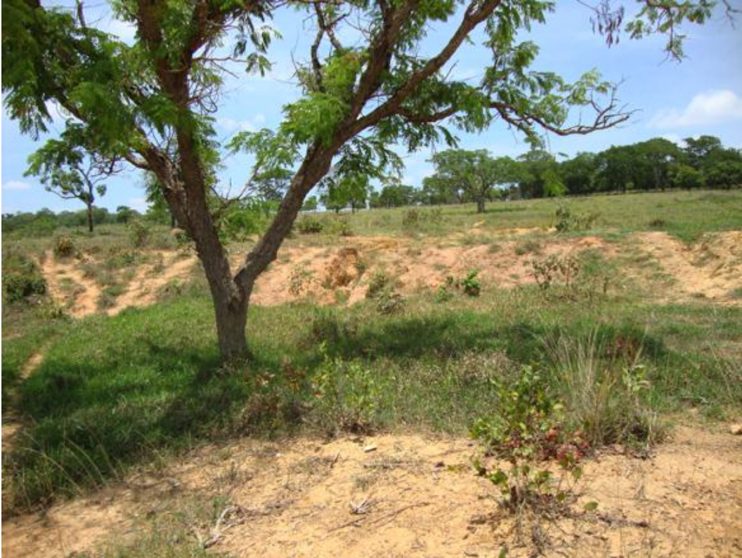
Figura 5: Processo erosivo instalado em área de Latossolo Vermelho-Amarelo em área de pastagem degradada.
