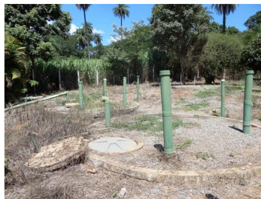
Figura 4-8 - Tanques sépticos e filtros anaeróbios da ETE São José de Almeida
