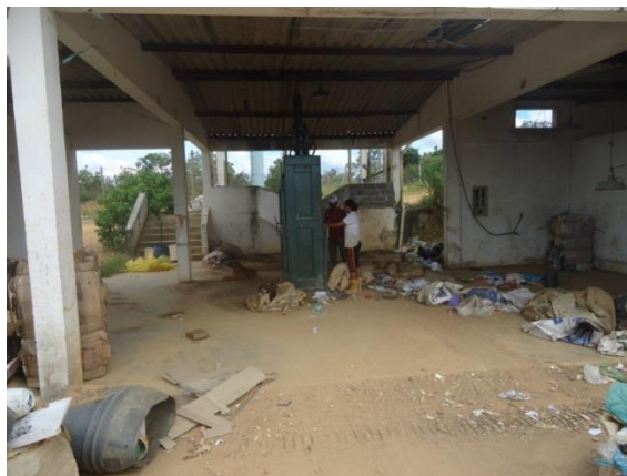
Figura 4-13 - Galpão com prensa hidráulica
