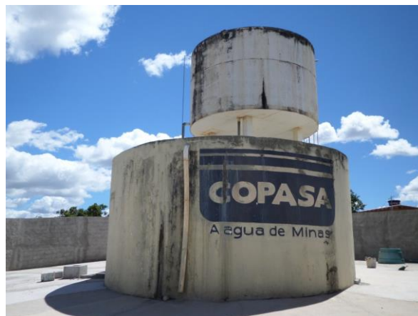
Figura 4.4 – Visão geral dos reservatórios do bairro Novo Brasil Fonte: COBRAPE (2014)
