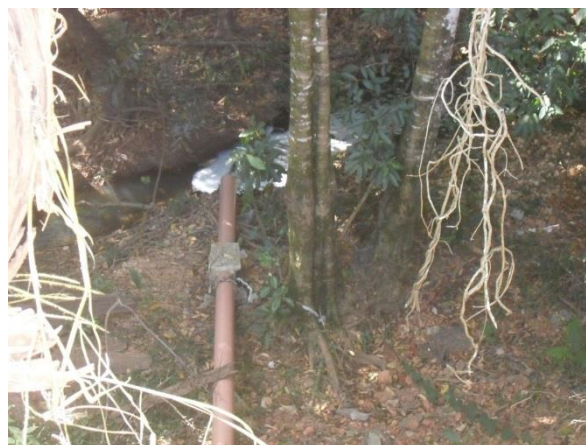
Figura 4.8 – Lançamento do efluente tratado no córrego Pau de Cheiro
