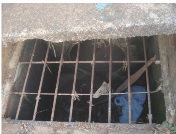
Figura 4.22 – Boca de lobo com grelha localizado na Rua Francisco Corrêa Sobrinho - Sede Fonte: COBRAPE (2014)
