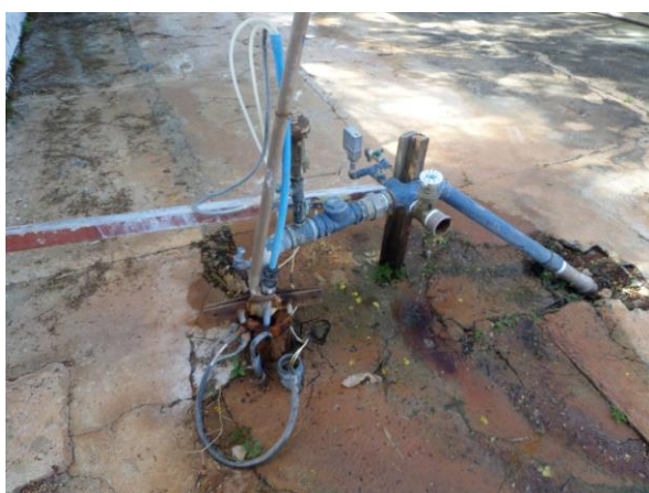
Figura 4.5 – Mangueras para a condução do cloro e do flúor até o interior do poço E-01 do sistema Núcleo João Pinheiro
