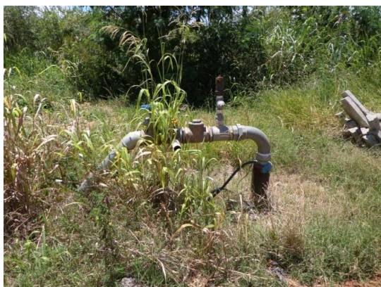
Figura 4.3 – Poço C-04 – sistema Funilândia Fonte: COBRAPE (2014)
