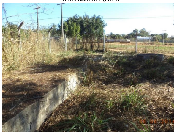
Figura 4.10 – Tanques anaeróbios da ETE desativada de Núcleo João Pinheiro
