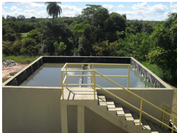
Figura 4.7 – Filtro anaeróbico de fluxo ascendente da ETE Funilândia
