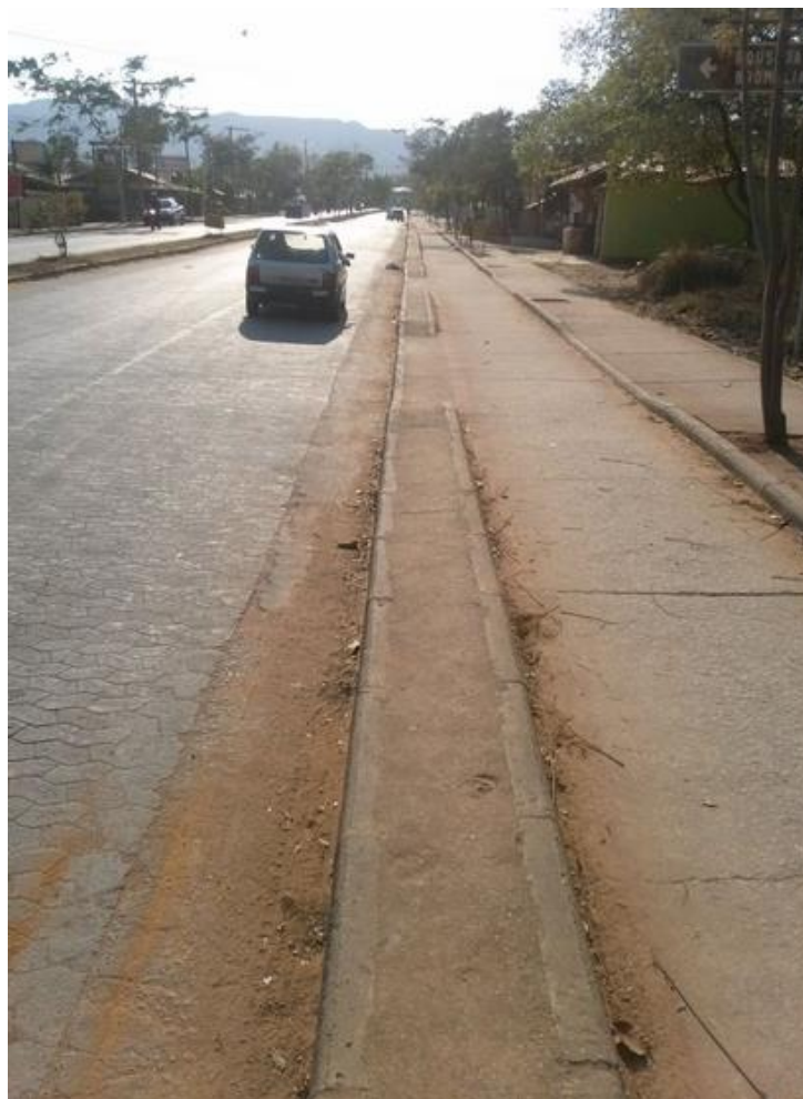
Figura 8.5 – MG-010 com acúmulo de detritos ao longo da via
