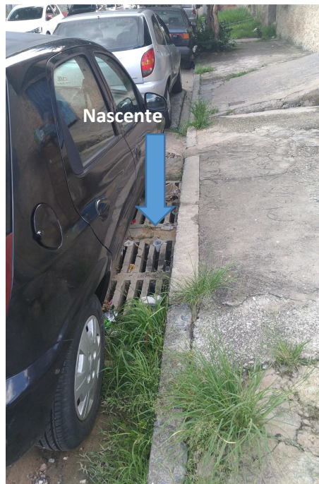
Figura 284 – Exemplo de nascente em área com alto grau de impermeabilização na Região da Sub-bacia do Baixo Onça – Nascente NAS709
