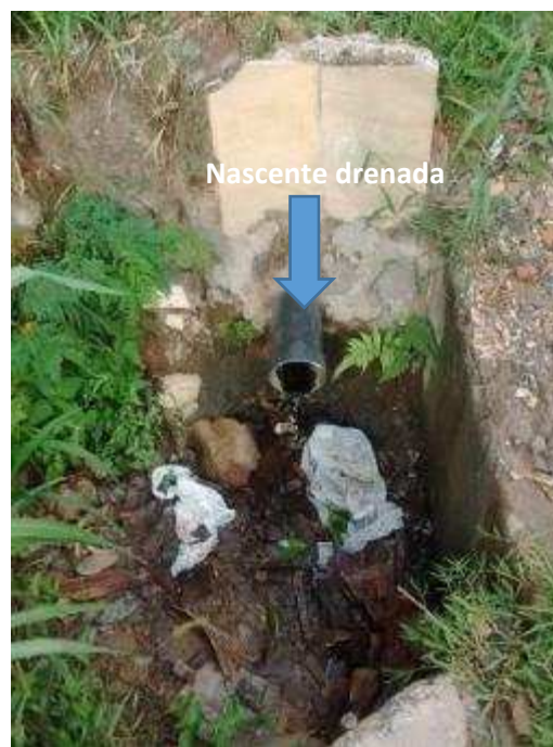
Figura 293 – Exemplo de nascente drenada na Região da Sub-bacia do Baixo Onça – Nascente NAS131
