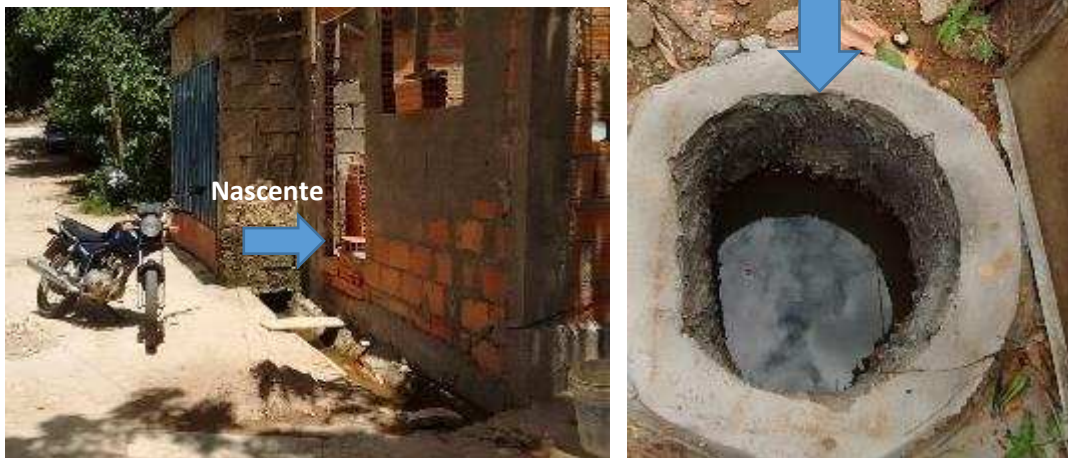
Figura 195 – Exemplo de nascente drenada confinada na Região da Sub-bacia do Ribeirão Isidoro – Nascente NAS187
